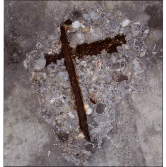
2 Durch Feuerverzinken vermeidbar: Betonkorrosion
