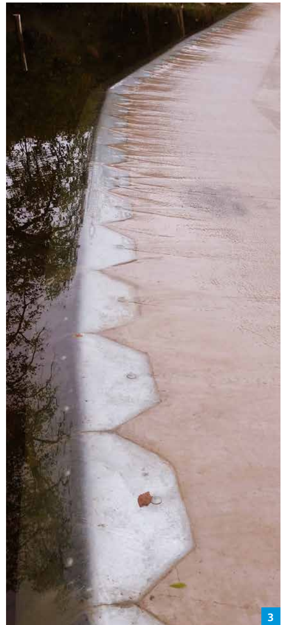
3 | Die Wehrkrone erhielt aus technischen und gestalterischen Gründen ein Sturzbett aus feuerverzinktem Stahl.
