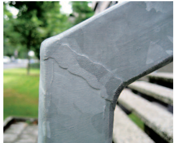
➔ Abb. 18: Aufgewachsener Zinküberzug an blecheben geschliffener Schweißnaht
