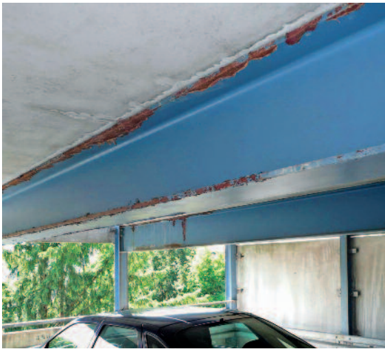
➔ Korrosion an beschichteten Stahlträgern eines Parkhauses
